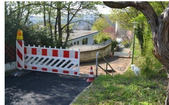
Umsetzung Quartiers- wegekonzepht Sukzessive Sanierung der Wege und Treppenanlagen durch den Bauhof
